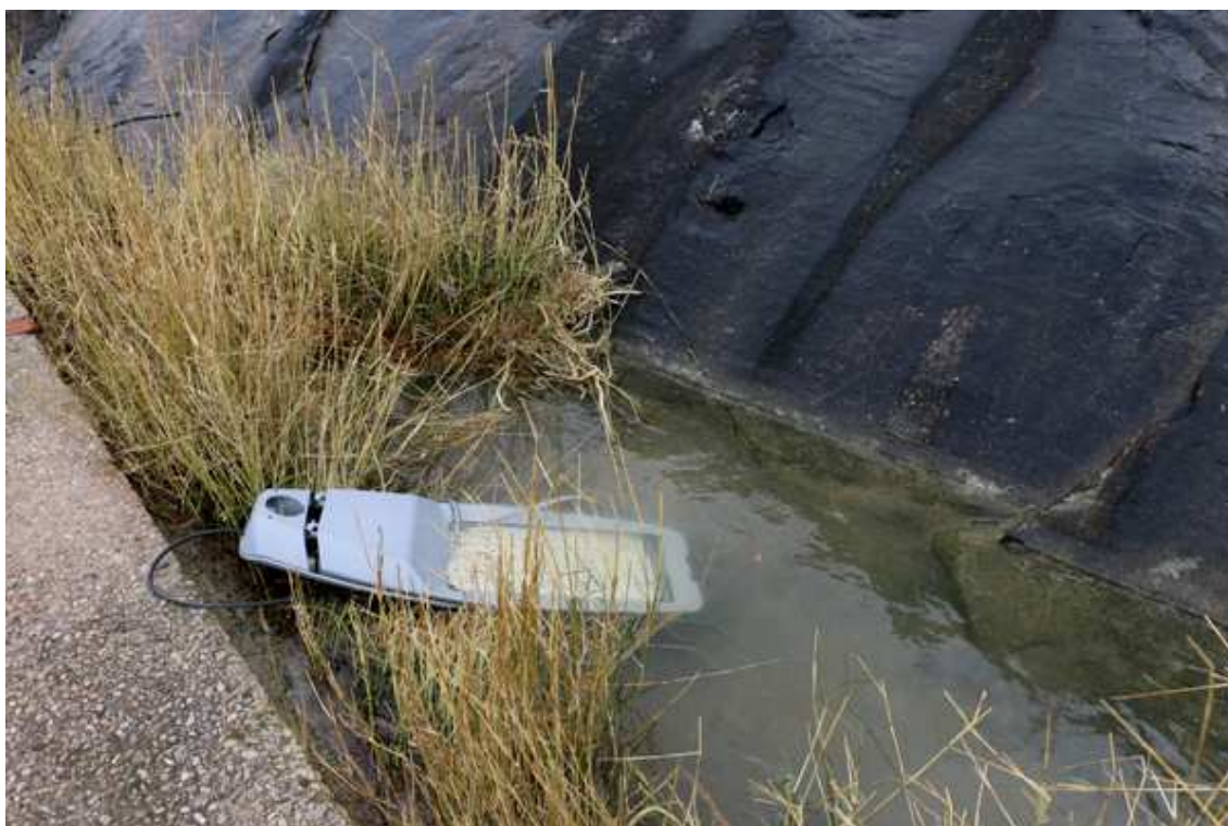
Restos de una farola dañada en el Paseo Nuevo
