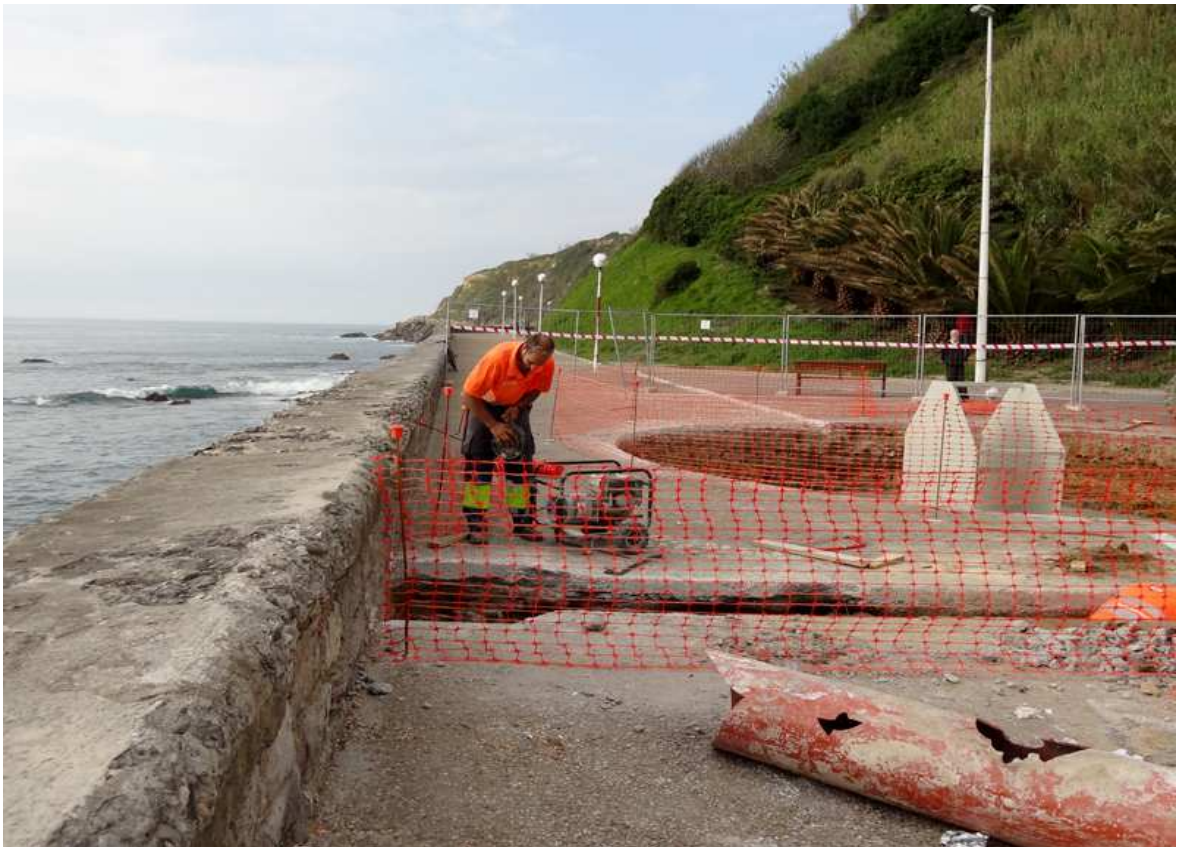
Poco espacio entre la escultura y el pretil de borde de paseo
